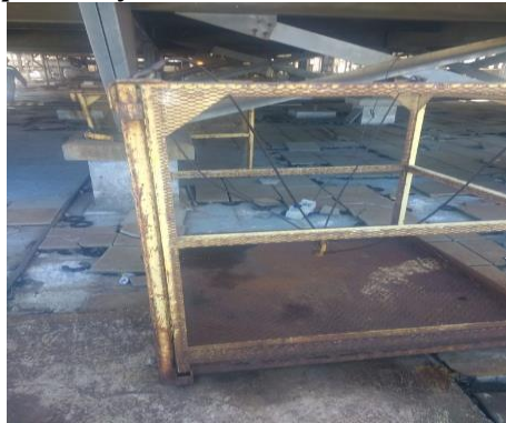
1- Guindola sin reparar
