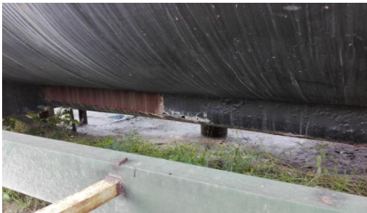
1 – Estado en el que se encontró el ciclón
